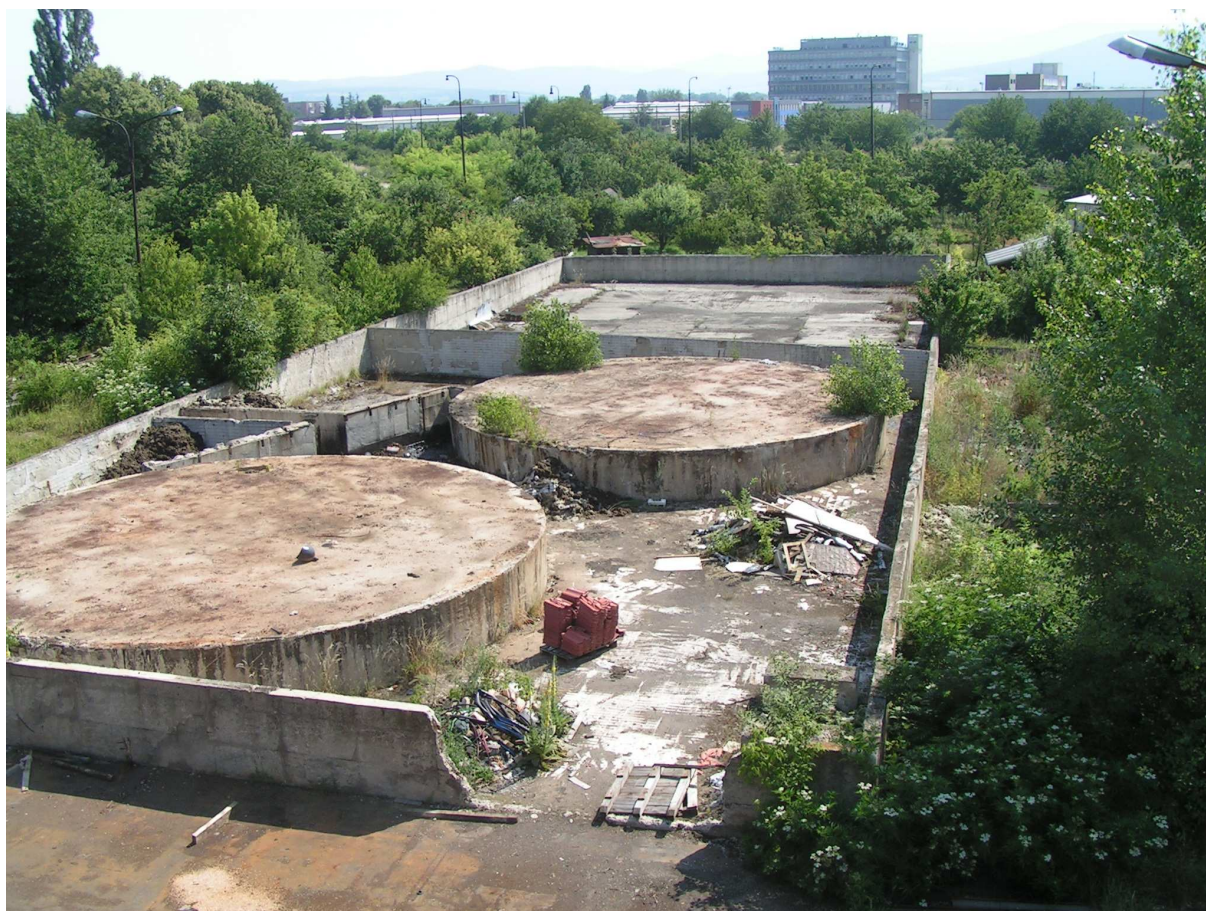
5/4 Zbytky havarijnej nádrže mazutu
